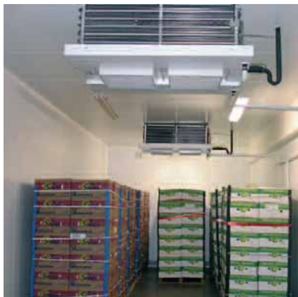
Chambre pour maturation et refroidissement rapide.
