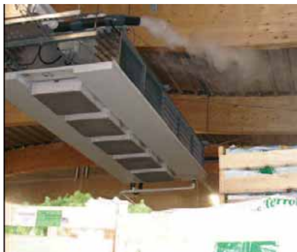
Chambre avec humidificateur.
